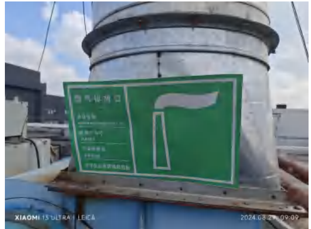
FQ3 排气筒及其标识牌
