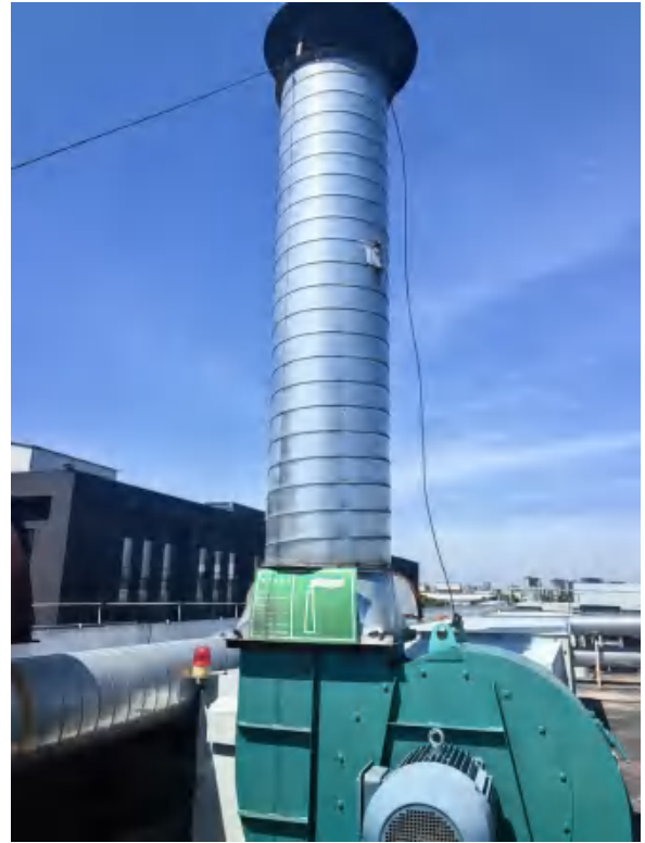
FQ2 排气筒及其标识牌
