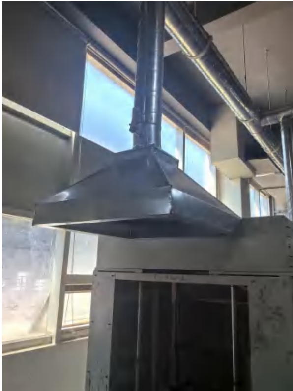
固化废气收集管道
