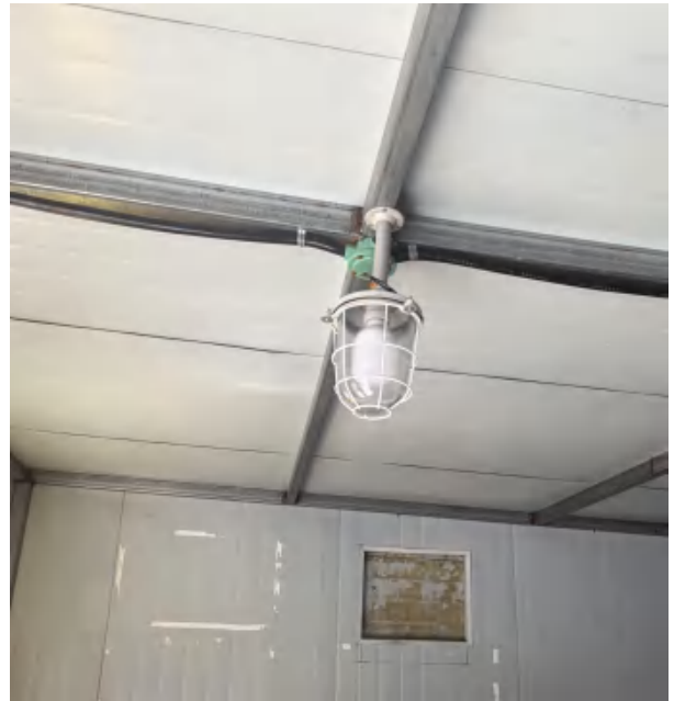
危废库内部照明设施
