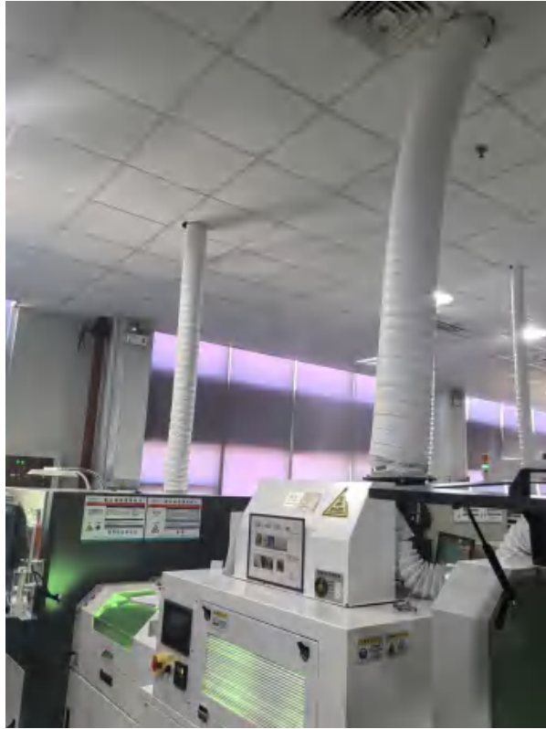
三防胶涂覆废气收集管道
