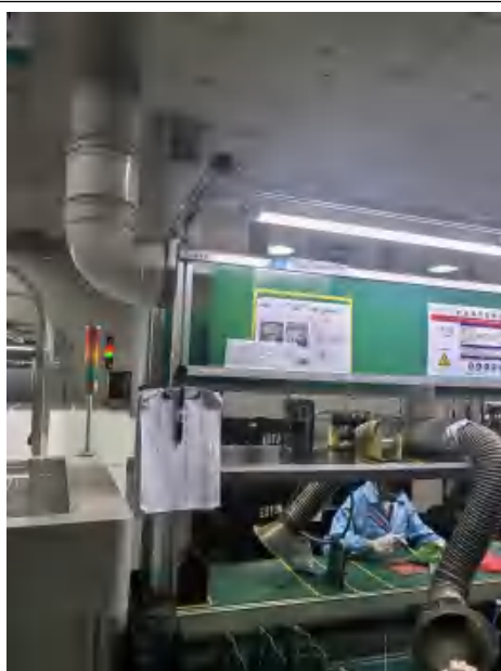
手工焊废气集气罩
