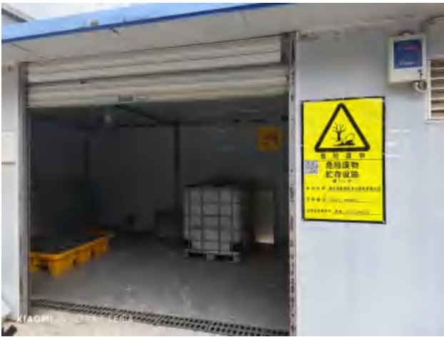
危险废物贮存设施标志牌
