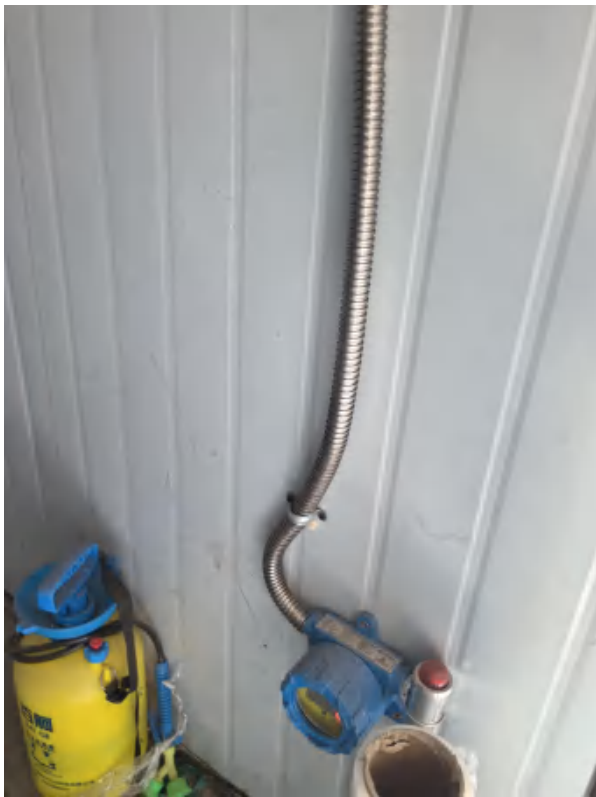
可燃气体泄漏报警装置
