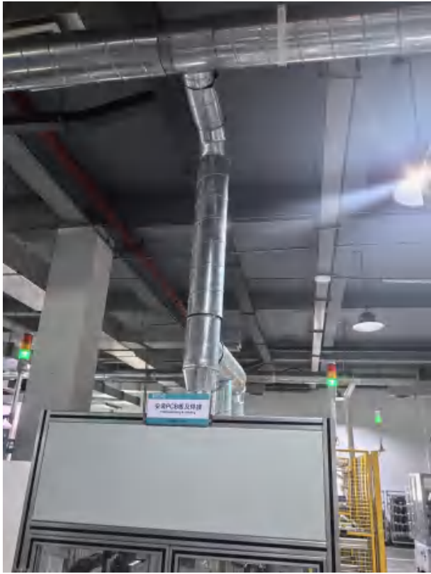
焊接废气收集气罩
