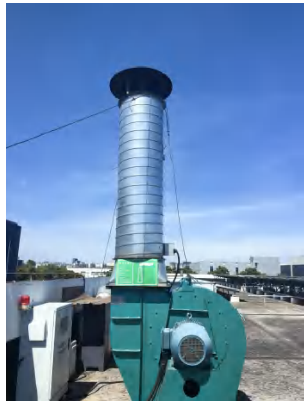
DA001 排气筒及其标识牌
