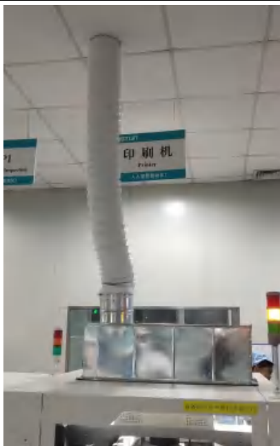
上板、印刷废气集气管道
