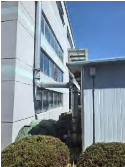
危废库废气收集管道
