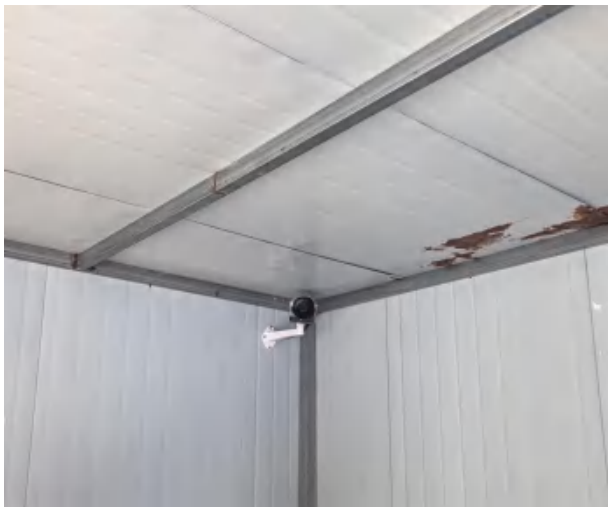
危废库内部监控
