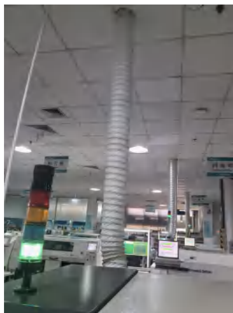
回流焊废气收集管道
