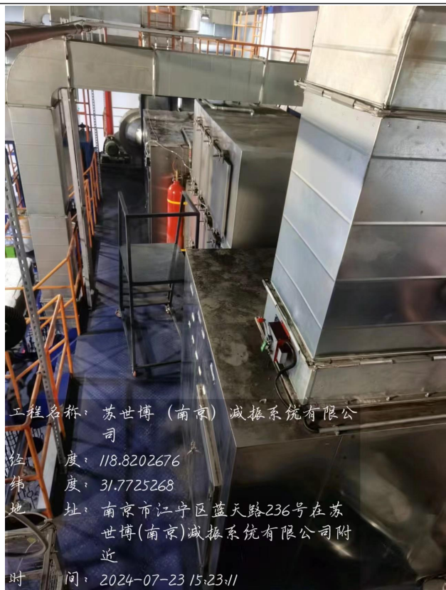
1#喷漆线过滤棉+二级活性炭装置 (TA003)
