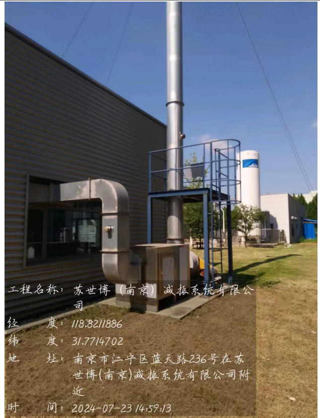
危险废物贮存库一级活性炭装置及排气筒 (TA006)
