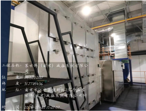
2#喷漆线过滤棉+二级活性炭装置 (TA005)
