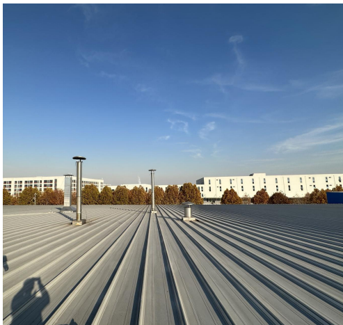
FQ2、FQ3、FQ4 和 FQ8 排气筒
