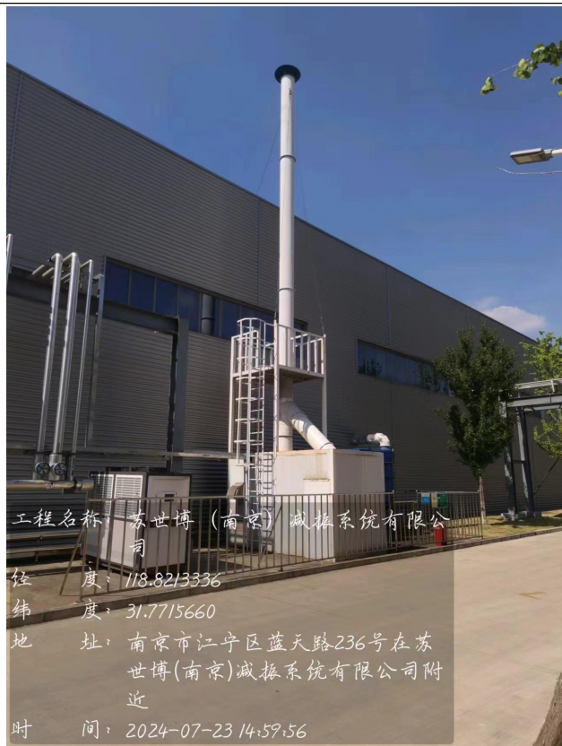
焊接烟尘滤筒除尘器 (TA001) 及排气筒 FQ1
