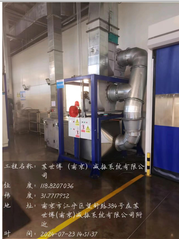
钢管清洗二级活性炭装置 (TA002)
