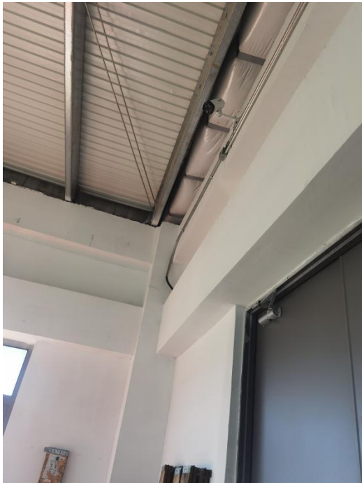
危废库内部视频监控
